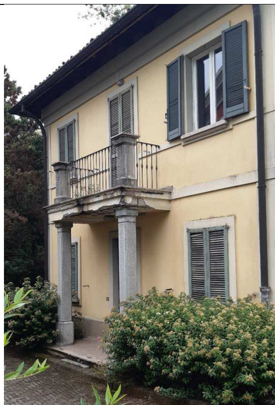
Figura 16 - dettagli stato di manutenzione portico di ingresso
